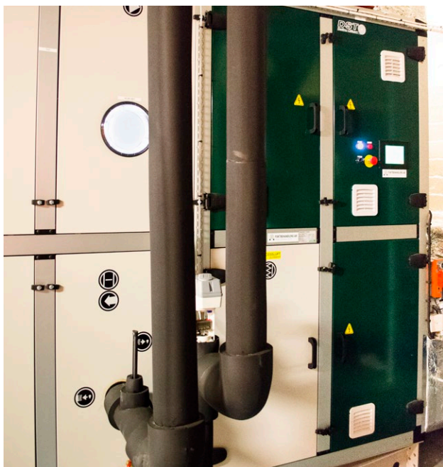
En installerad Flexisorb DST avfuktare i Oasens ishalls ventilationsrum
