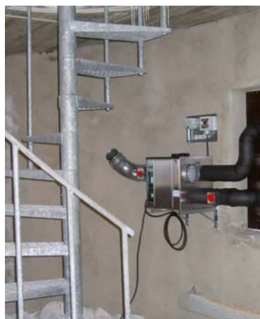
Installerad avfuktare i ventilutrymmet, i vattentornet i Lit. Fotografi från Polair.
